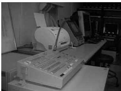
本庁舎の同報無線機器
