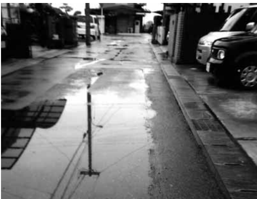
永和台の雨後の状況
