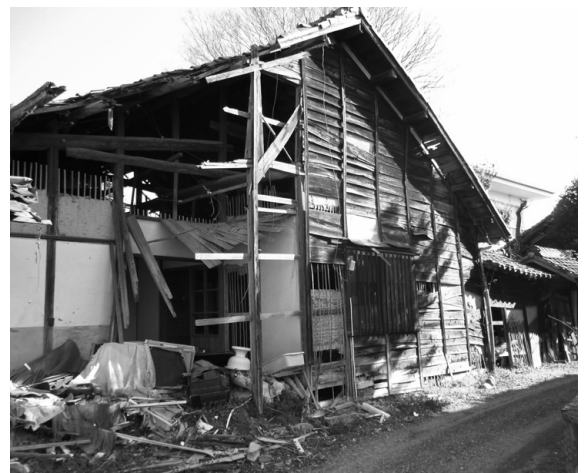
▲空き家の現状
