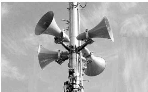
▲防災行政無線屋外スピーカー(市内115カ所に設置)
