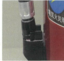
× 消火薬剤の漏れ
