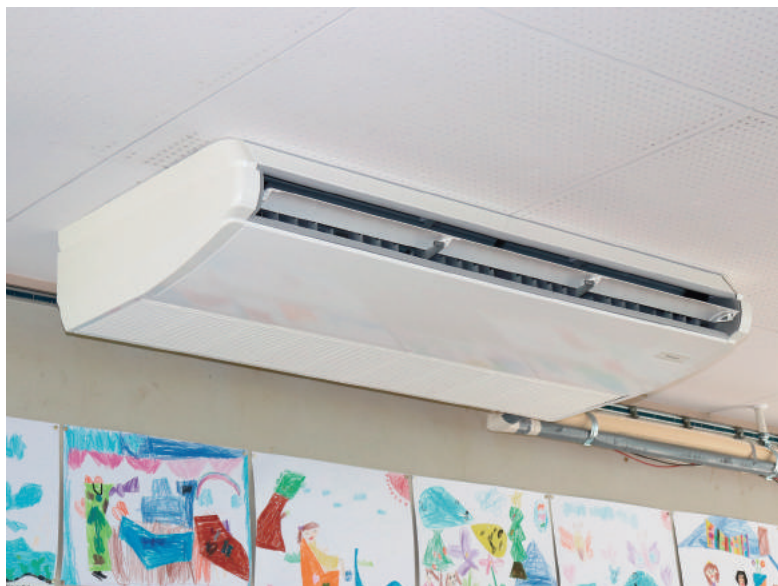
▲草平小学校で稼働し始めたエアコン
