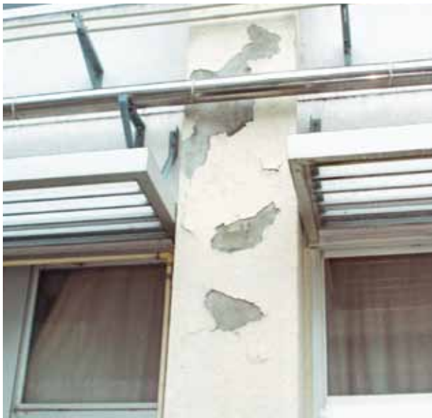
▲老朽化し改修が必要な校舎(立田北部小)
