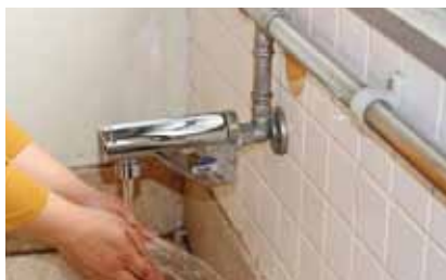
▲自動水栓の蛇口
