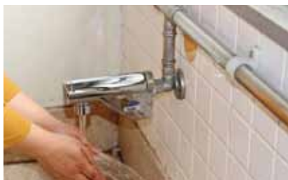
▲自動水栓の蛇口
