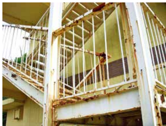
▲老朽化している佐屋小学校の非常階段
