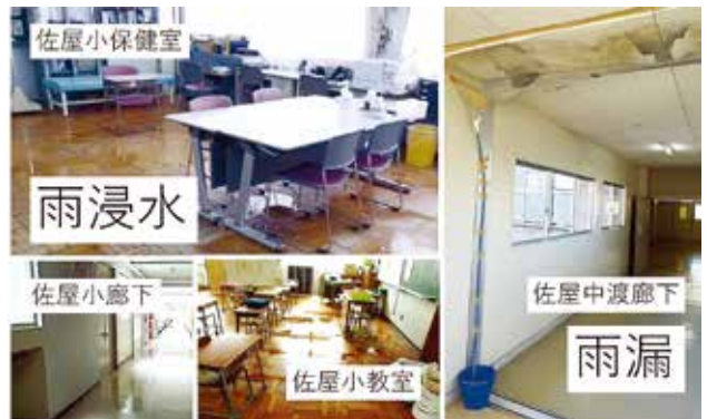
▲老朽校舎の雨浸水や雨漏
