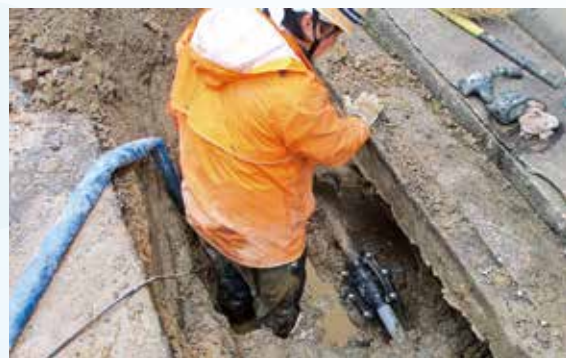
劣化した水道管と漏水修繕の様子
